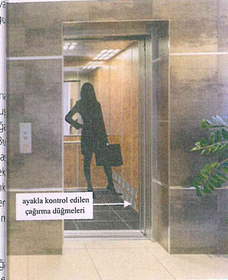
Şekil 5. Ayakla kontrol edilen çağırma düğmeli asansör (Navaratnam, v.d., 2022).
